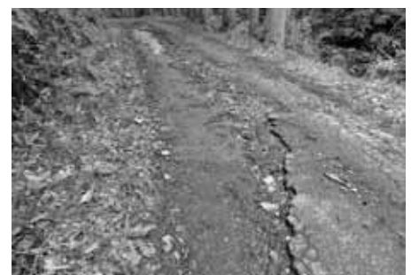
舗装面が荒れた道路
