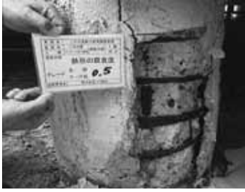
腐食した基礎部 (耐力調査)
