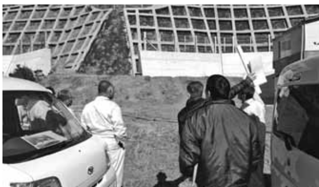
急傾斜地崩壊対策施工現場(国補助事業 清川・大川地区)
