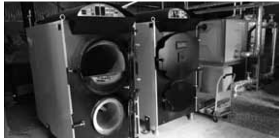
鶴の湯温泉薪ボイラー
