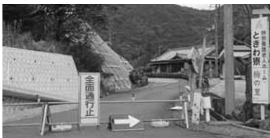
町道滝線のり面崩落現場
