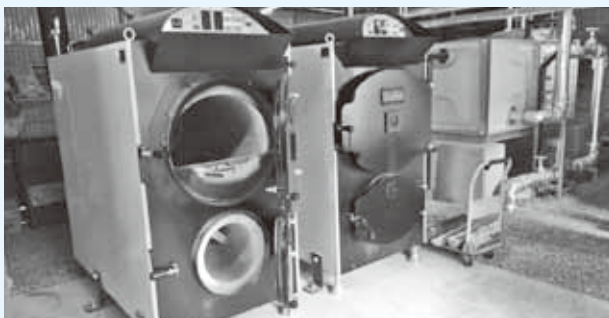
薪ボイラー（鶴の湯温泉）
