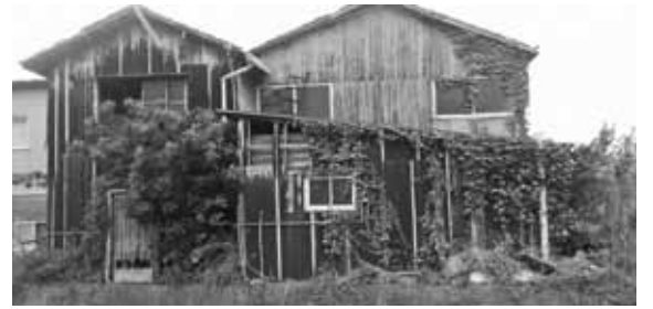
倒壊の恐れがある空き家
