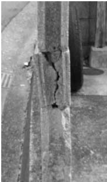
老朽化したコンクリートブロック塀
