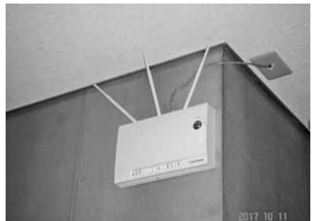
Wi-Fi 無線ルーターの設置例
