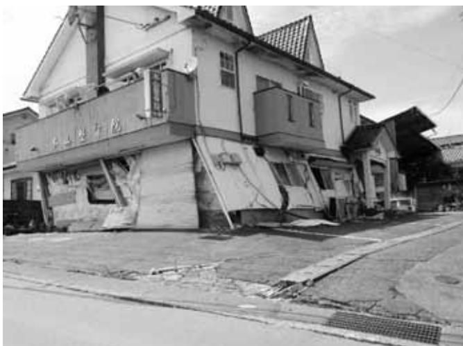
1階部分の傾きが大きい
