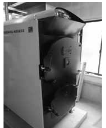
松尾川温泉の薪ボイラー
