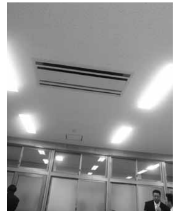
教室のエアコンパネル
