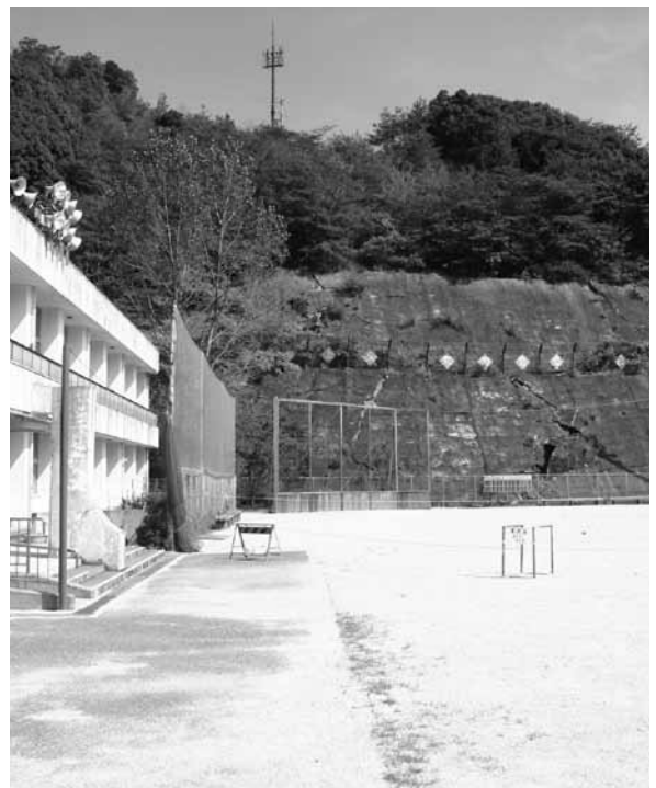
崩壊した高城小学校の法面
