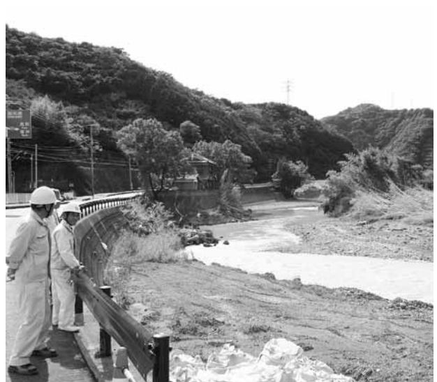
辺川地区河川擁壁損壊、陥没現場
