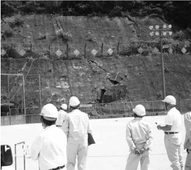
高城小学校グラウンド側法面損壊
