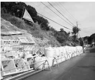
被災した町道
