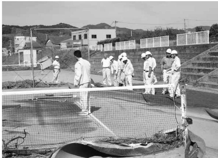
共和運動広場、テニスコート浸水現場
