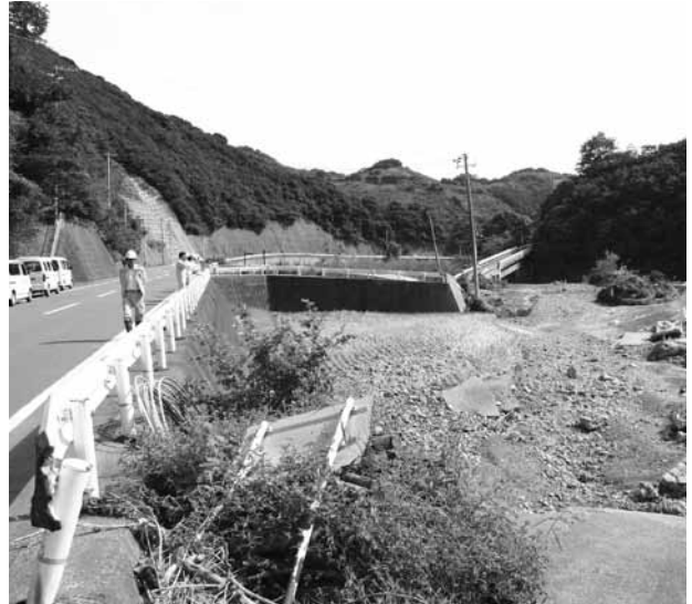
広野地区河川擁壁、田の流失
