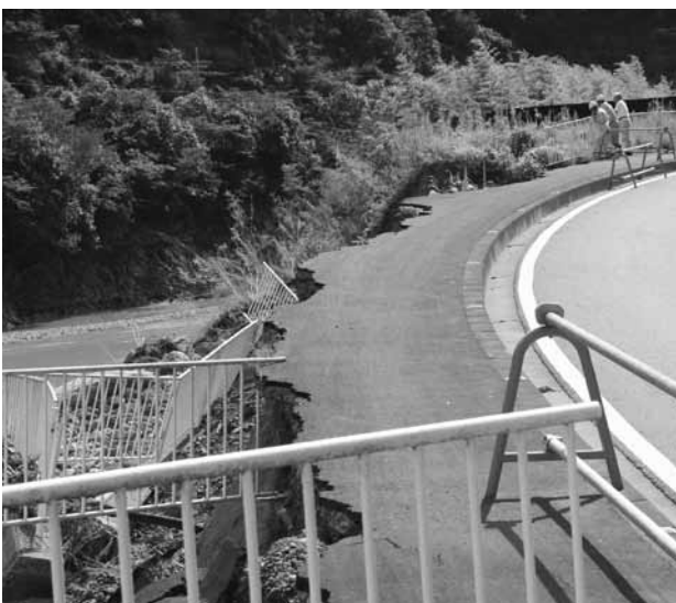
国道424東本庄地内歩道損壊
