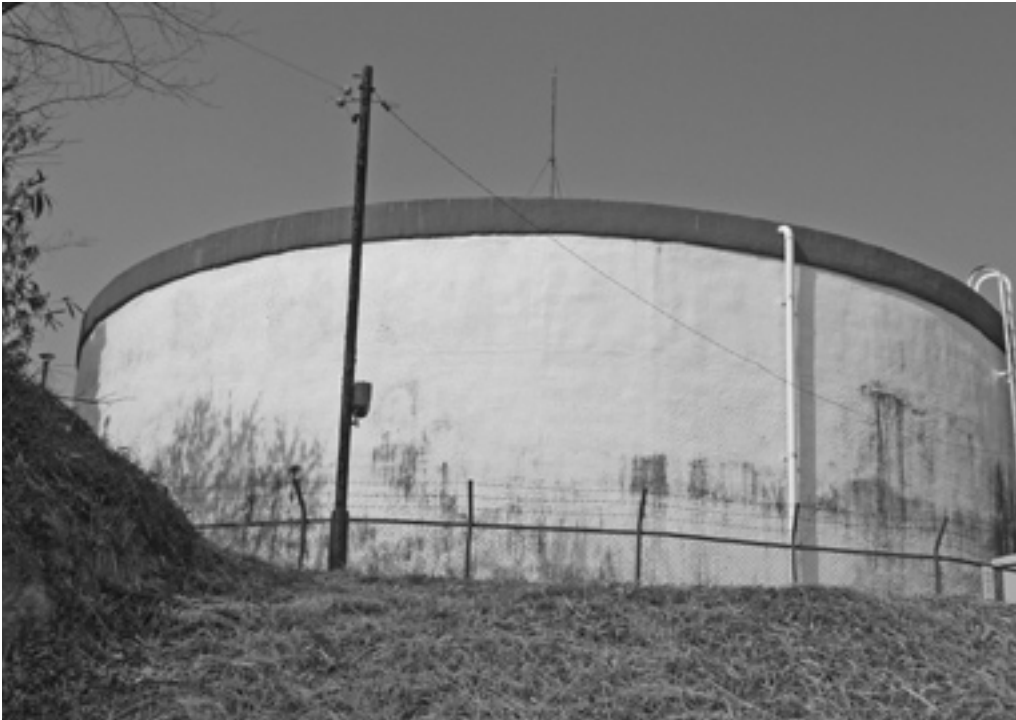
貯水タンク(東部配水池)
