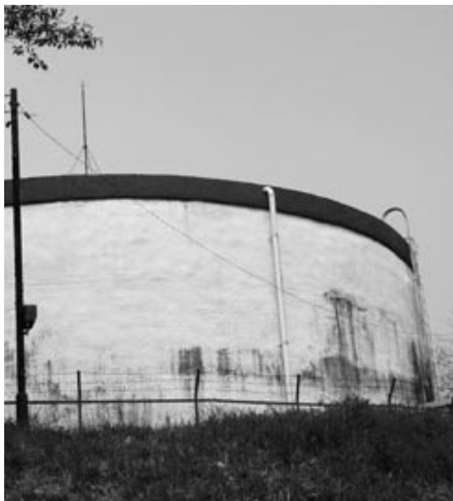
東部配水地のタンク
