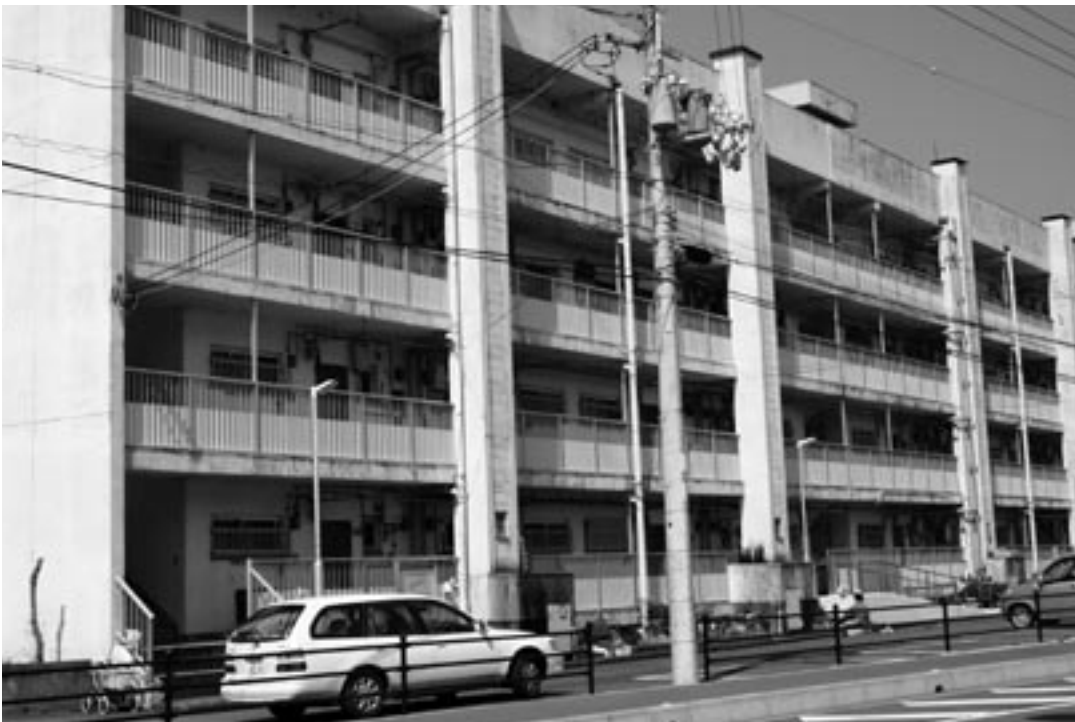
建て替えが必要な改良住宅
