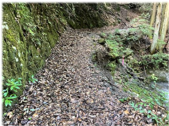
＜路側が崩落した箇所＞
