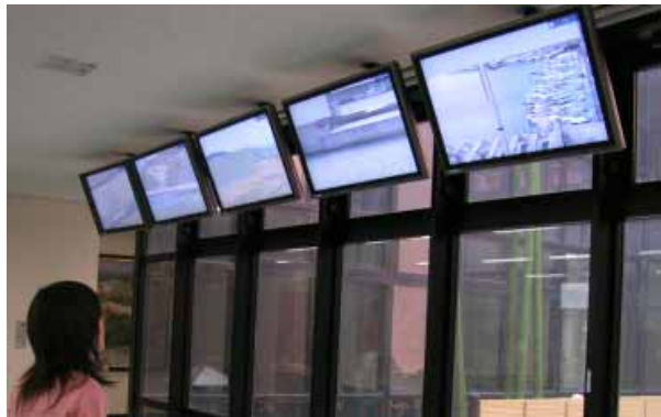
役場庁舎2階、総務課と商工水産課の前に設置された防災モニター。堺漁港、国民宿舎 紀州路みなべ、千鹿浦公園、うめ振興館、岩代小学校に設置された防災カメラからリアルタイムに映像が送られてきます
