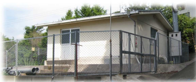
晩稲中継ポンプ所
