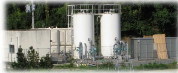
西本庄浄水場
