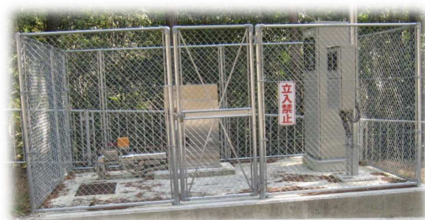
高城低区中継ポンプ所
