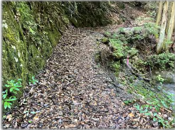
〈路側が崩落した箇所〉
